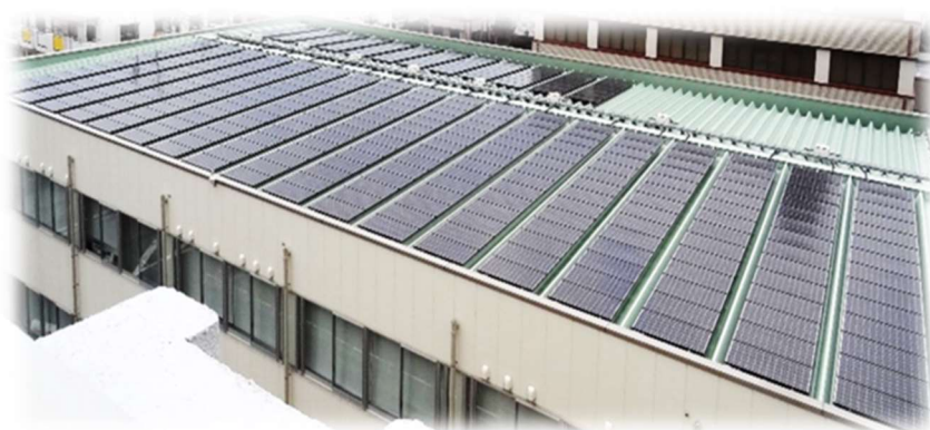
第3分庁舎の太陽光発電システム
