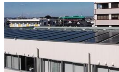
第3分庁舎の太陽光発電システム
