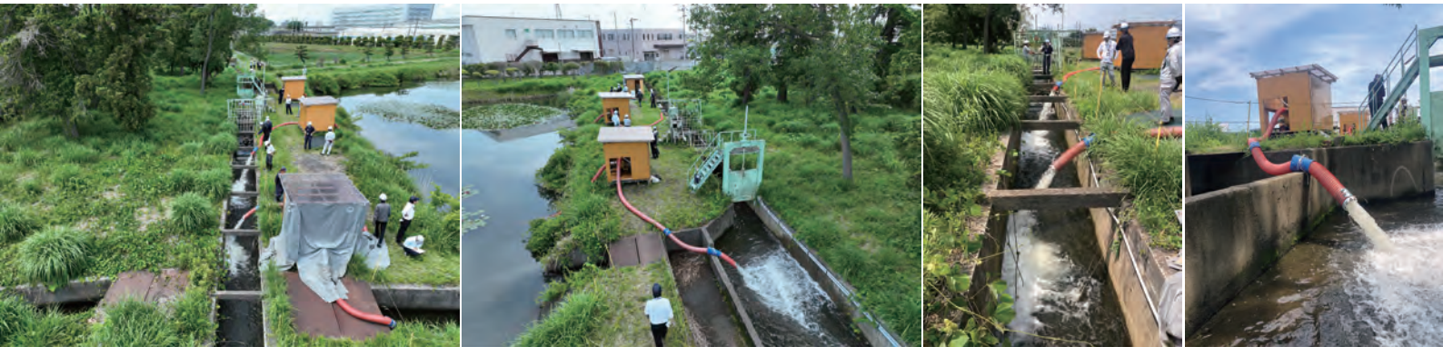
▲左から順に，可搬式ポンプの事前放流状況：下流側から撮影→上流側から撮影→排水状況1→排水状況2
