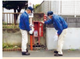
屋外設置消火器の点検
