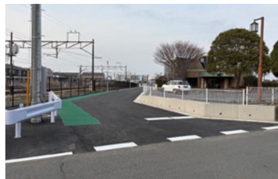
▲新設した東口南アクセス道路（市道佐野地区690号線，延長205m，幅員5～6m）
