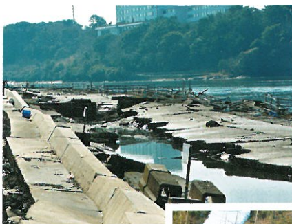
▲液状化で全壊した河川口
