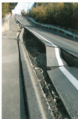
▲寸断された道路
