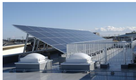
那珂湊第二小学校の太陽光発電システム
