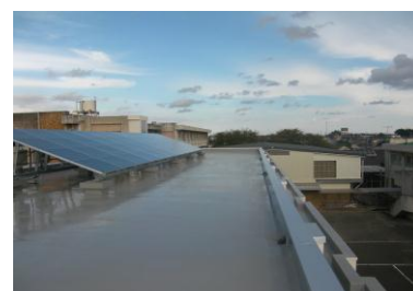
大島中学校の太陽光発電システム
