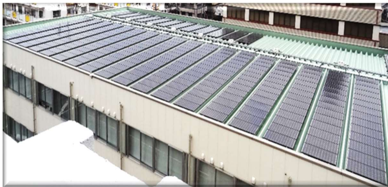
第3分庁舎の太陽光発電システム
