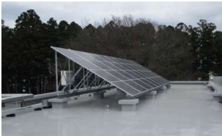
太陽光発電施設
