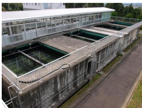
上坪浄水場のろ過施設
